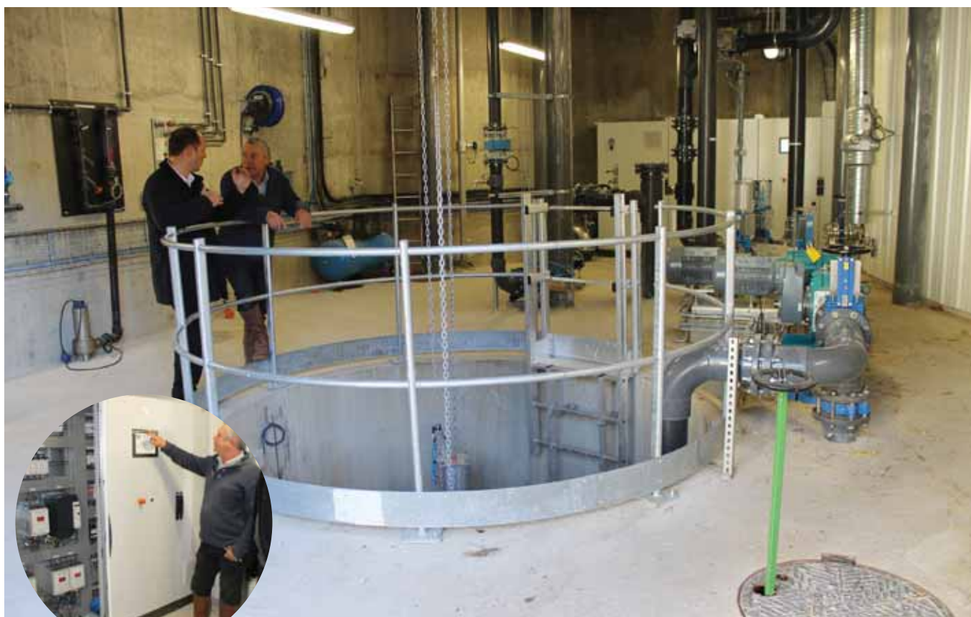
La gaine technique : cœur de l'installation qui bénéficie d'un pilotage entièrement informatisé.
